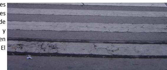
Mal estado de señalización horizontal y asfaltado de calzada
