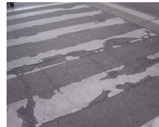
Deterioro de la señalización horizontal en la calzada y del asfaltado.
