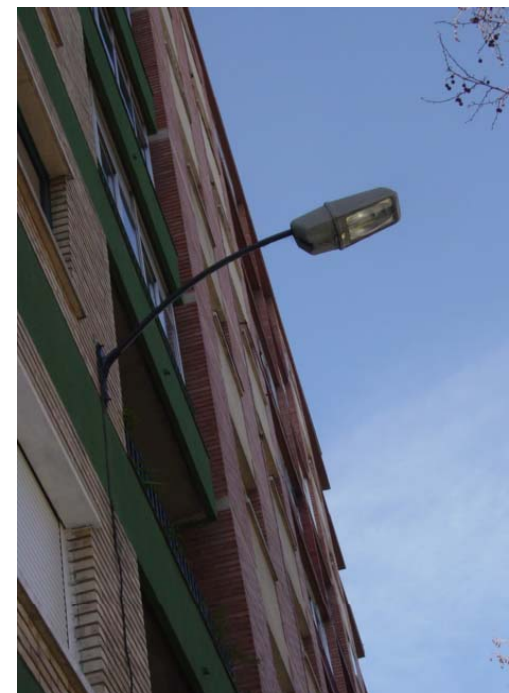
Alumbrado público inadecuado, tipo mural, estilo industrial y colocado a tresbolillo.
