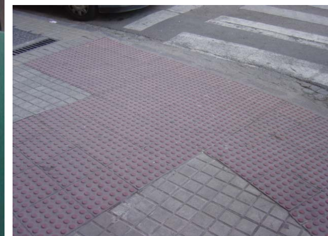
Pavimento de aceras en mal estado
