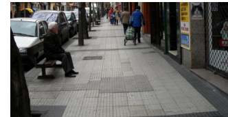
Pavimento de baldosa en estado de conservación desigual, deficiente en general.
