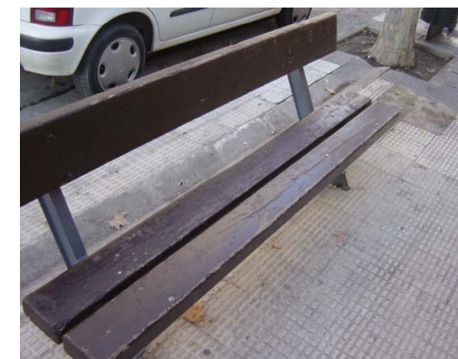
Mobiliario urbano en mal estado de conservación
