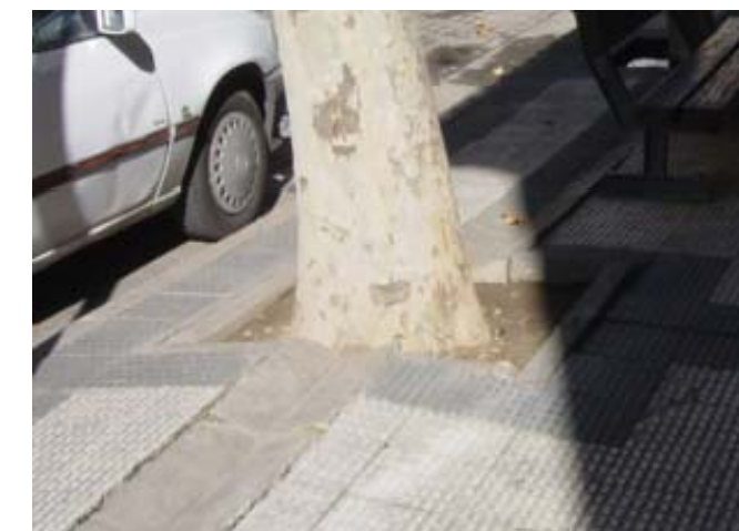
Alcorques y rígora longitudinal sin elementos de protección, y pavimento levantado por raíces de arbolado de gran porte
